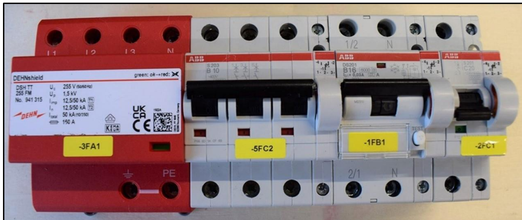
Abb. 14 Blitzschutz und Leitungsschutzschalter im ControlShield hinten Mitte
